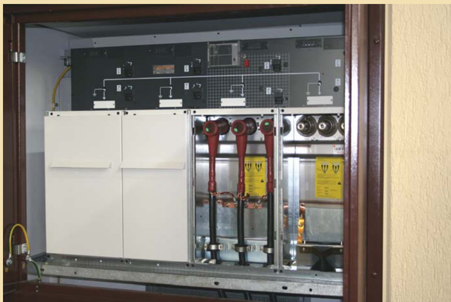
Отсек распределительного устройства высшего напряжения (УВН)
