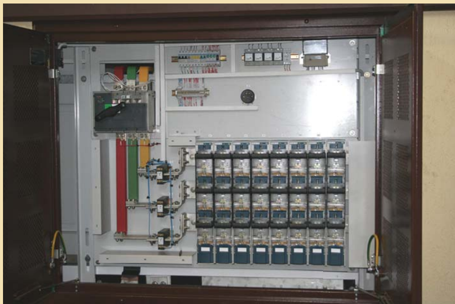
Отсек распределительного устройства низшего напряжения (РУНН)
